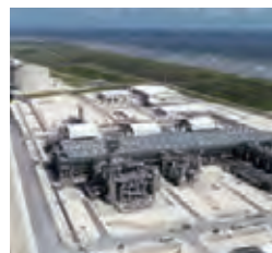
Freeport LNG Terminal in the United States Courtesy of Freeport LNG Development, L.P.
