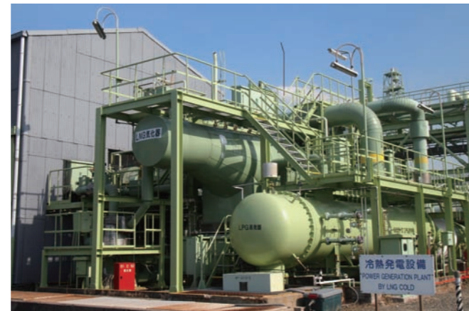
Facility for LNG cryogenic power generation at Senboku LNG Terminal
