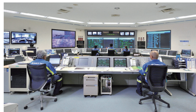
Central control room at an LNG terminal
