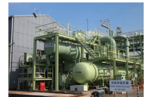
LNG cryogenic power generation facilities at Senboku LNG Terminal
