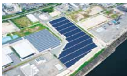
西島太陽光発電所
